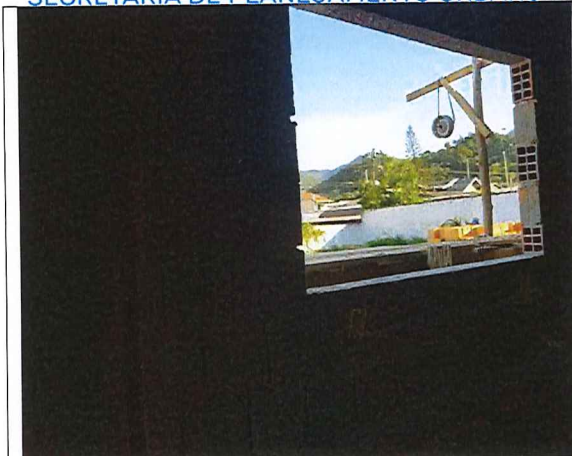
Janela sem contraverga no lado esquerdo - interno
