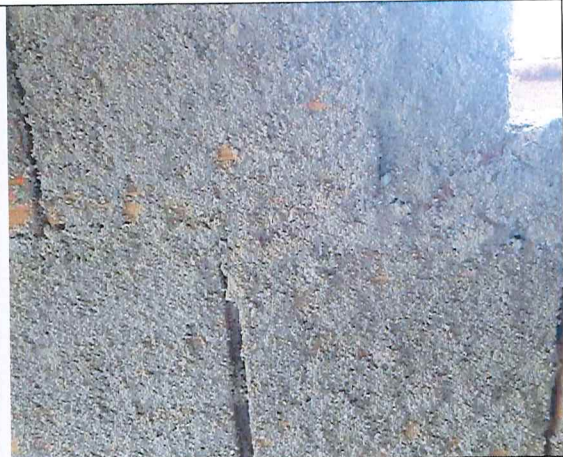
Vista do local sem a contraverga - interno
