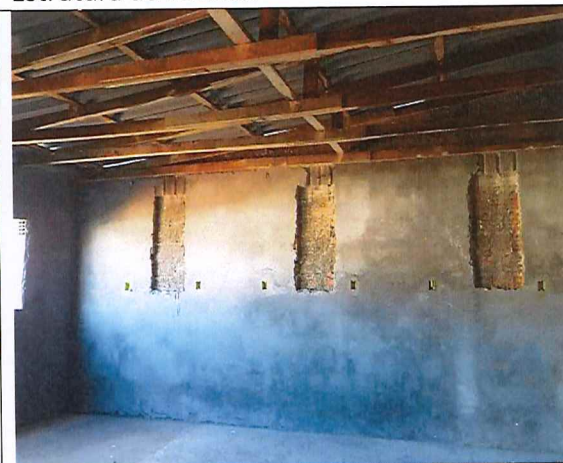
Reboco na parede interna.
